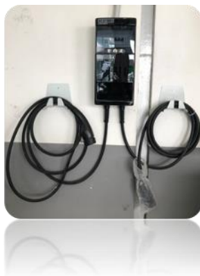
Punto de carga de vehículos enchufables
