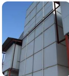
Columna de salida de emisiones de cabinas de pintura
